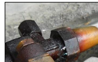
フレア継手部の劣化
