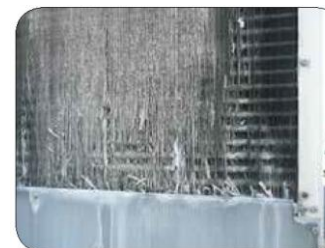
熱交換器の劣化
